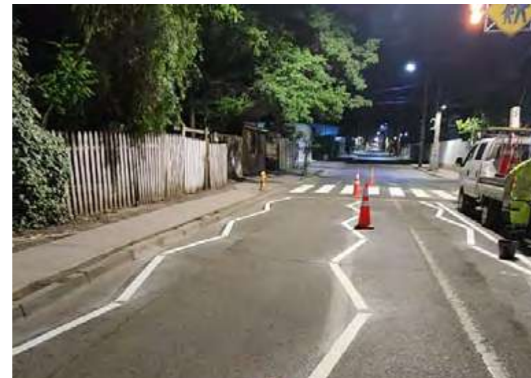
Señalización y Demarcación
